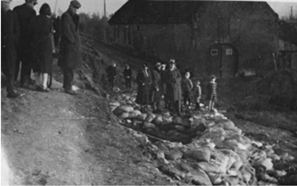
De griffier van het waterschap de Maaskant, J.J. van Gulik (man met hoed in het midden), neemt een kijkje bij de dijkverzakking en de afdichting met zakken grind.
